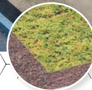
Gestion de l'eau pluviale avec plantes sédum
